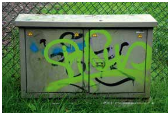
Een bekladde schakelkast.
