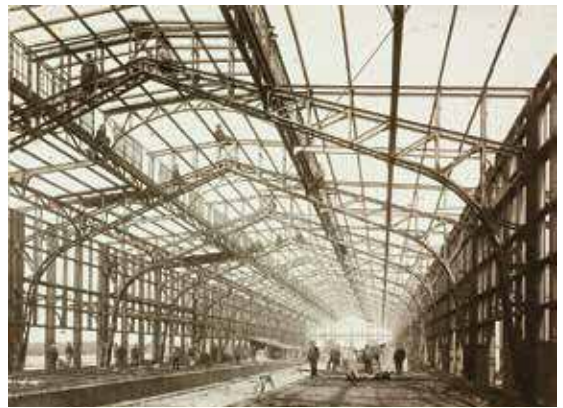
Opbouw douaneloods in 1906 (collectie spoorwegmuseum nr. 5361). "Er was in die enorm uitgestrekte, met glas overkapte loodsen, een nijpend tekort aan kleding, dekens, warmte en (vooral 's avonds) licht."
