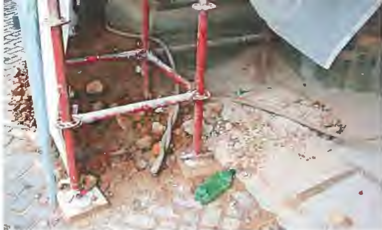
De hoeveelheid puin en steengruis aan de voet van de steiger laat zien hoe verwoerd bepaalde delen van de torenromp waren.
