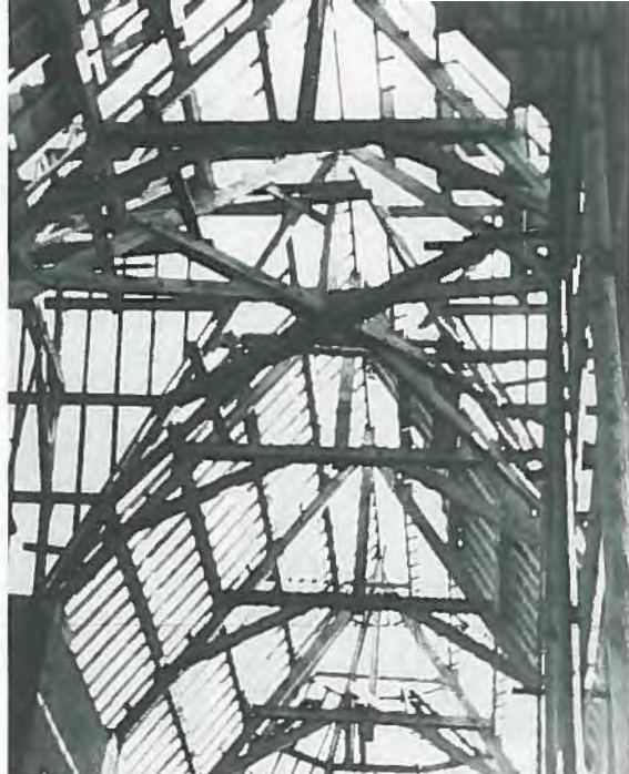
Boven het kruispunt van kerschip, dwarsbeuken en priesterkoor ontstaat een wirwar van balken die het dak moeten dragen en waaraan straks de houten tongewelven bevestigd zullen worden.
