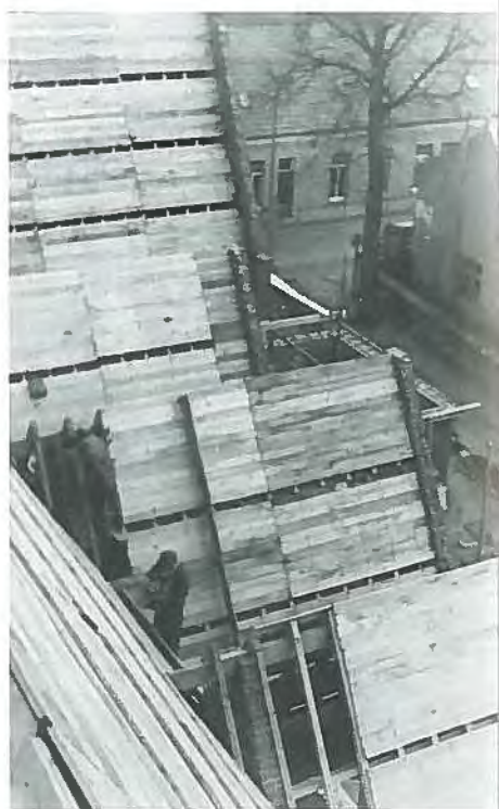
Nog een beeld van dat dakbeschot. In de diepte zien we de hoek van het Kerkplein (waar nu het overdekte terras is) en een stukje van de Molenstraat.
