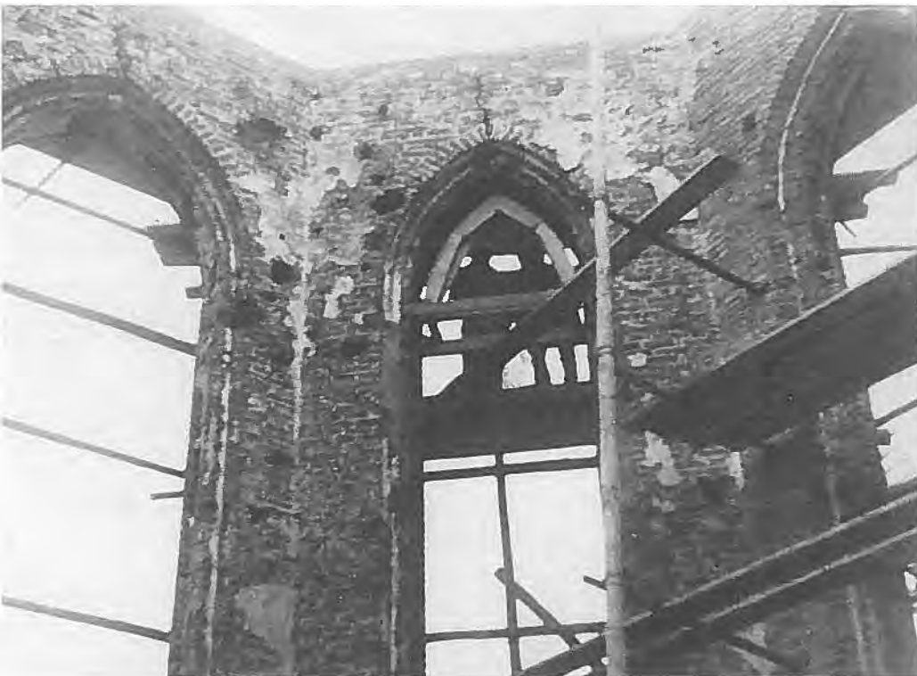
Rond de spitsbogen is de schade aan de muren vrij ernstig.
