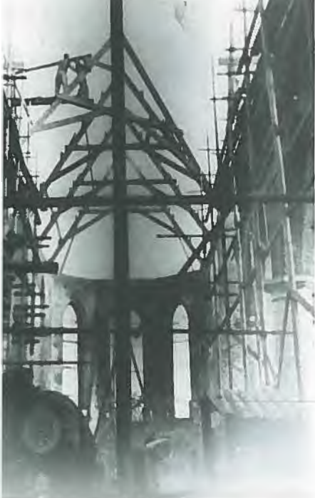
Arbeiders zonder hoogtevrees bouwen de dakconstructie boven het schip van de kerk.
