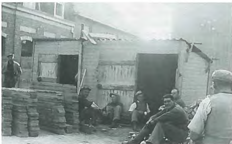
Op de hoek van de Kerkstraat, tegenover ingang van de kerk, staat de bouwkeet. De werklui hebben hun schaft verdiend.
