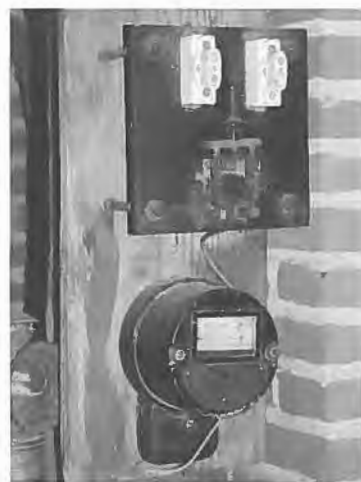
Een schakelbord zoals dat in de 50-er jaren in iedere woning van Baarle-Hertog hing
