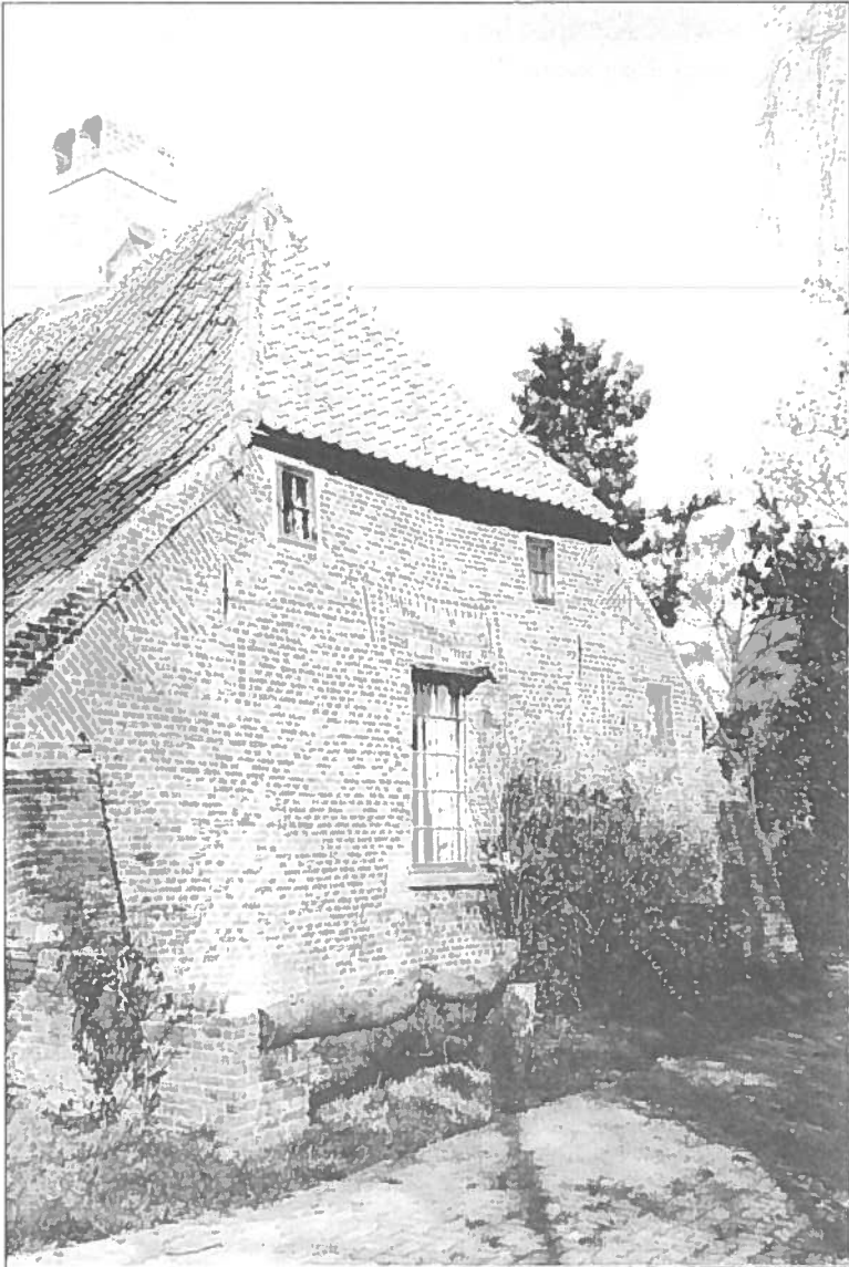
Gevel met jaartal en afveerkruis. Links is de verandering van de daklijn te zien
