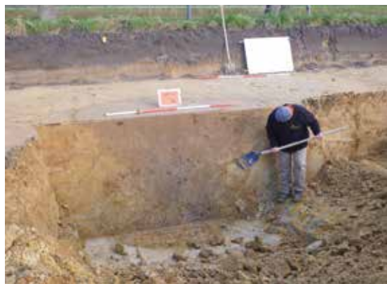
Opschaven van een vroegmiddeleeuwse waterput. De bodem van de put is nog niet blootgelegd.
